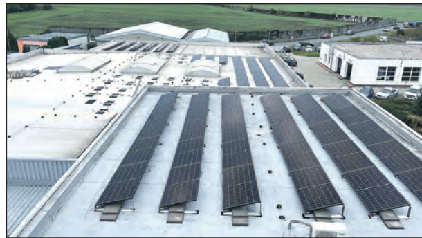
Fotovoltaická elektrárna by neměla chybět na střeše jakékoliv výrobní či skladové haly. Na této střeše právě probíhá její montáž.
