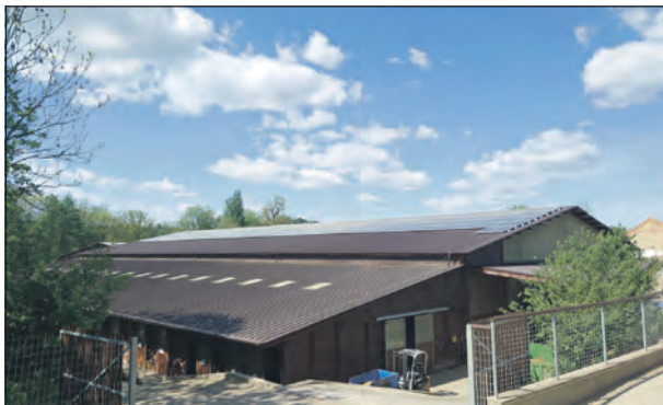
Finálně položené panely o celkovém výkonu 99,96 kWp.
