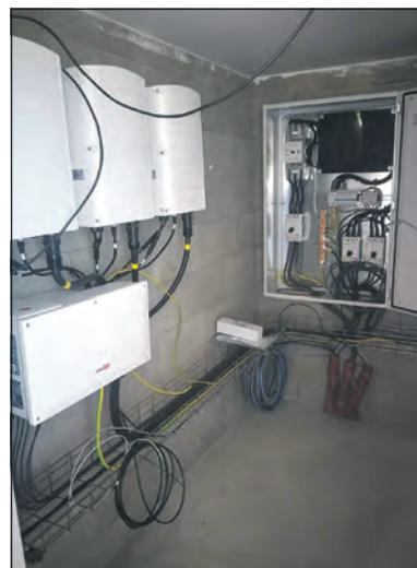
Na levé straně jsou vlastní zařízení síťového střídače SolarEdge, vpravo, na čelní stěně, je umístěn rozvaděč AC.
