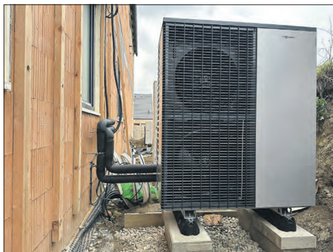
Tepelné čerpadlo Viessmann u novostavby.
