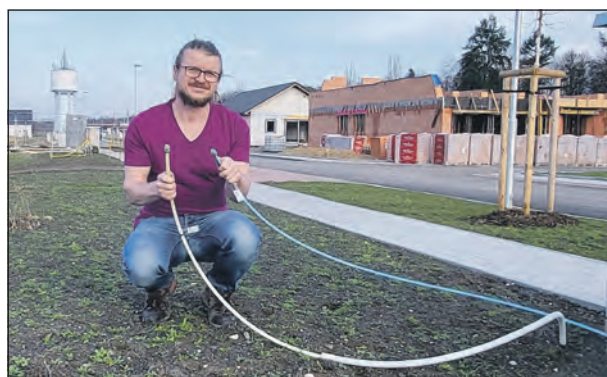
Majitel Altnetu Martin Kratochvíl ukazuje připravené optické chráničky pro projekt Na Hájích ve Slaném.
